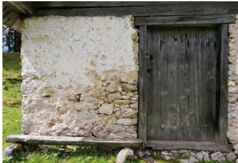
Lesen vratni okvir, vgrajen v kamnit zid, je izdelan iz tramov dimenzije 14 cm x 16 cm. Planina Vodični vrh, sirarna
